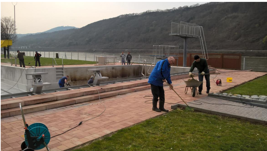
Gearbeitet wird gleichzeitig an mehreren Stellen: Im Becken, Rinne rund ums Becken und Raseneinsaat.
